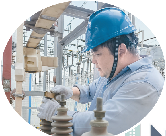
处理设备隐患。
