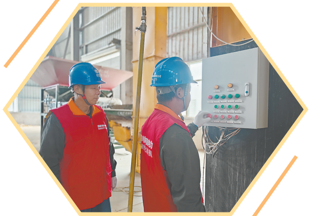
↓10月11日，孟州市供电公司工作人员在企业烘干车间检查用电设备。 平容荣 摄
