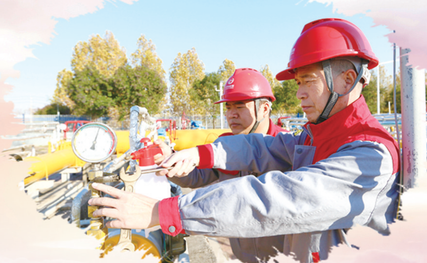
工作人员在检修压力表。
