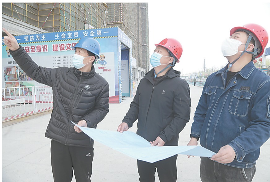
3月29日,解放区“万人助万企”帮扶小分队在一家建筑工地了解项目进展情况。为贯彻落实我省“万人助万企”活动部署要求,解放区组建100人的“万人助万企”帮扶小分队,深入30家企业及建筑工地开展精准服务,协调解决实际问题,提振企业发展信心。 李良贵 摄
