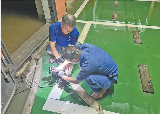
焦作建业物业人员增加临时水泵抽排。
