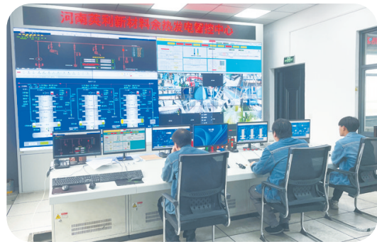
工人通过智控系统操纵余热发电设备。 本报记者 王 颖 摄
