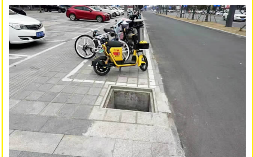
在红日路深圳大厦路口,有一个窨井盖缺失,存在安全隐患。
