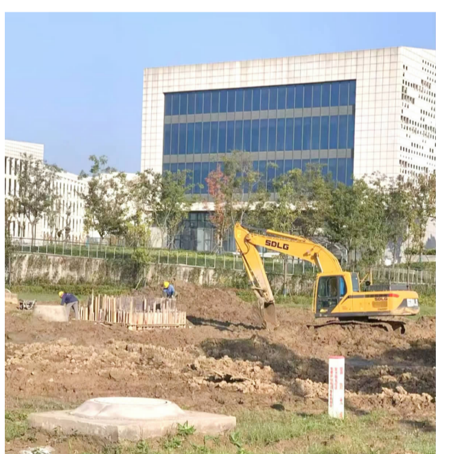
近年来,我县不断加快基础设施建设步伐,完善城市功能,提升城市颜值,为广大市民营造更加宜居的生活环境。图为施工人员在滨河新城推进基础设施建设。
