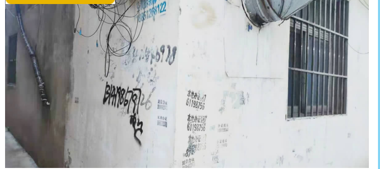
在文明巷,墙体上有多处小广告,长期无人清理。
