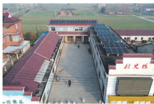
屋顶分布式光伏发电项目
