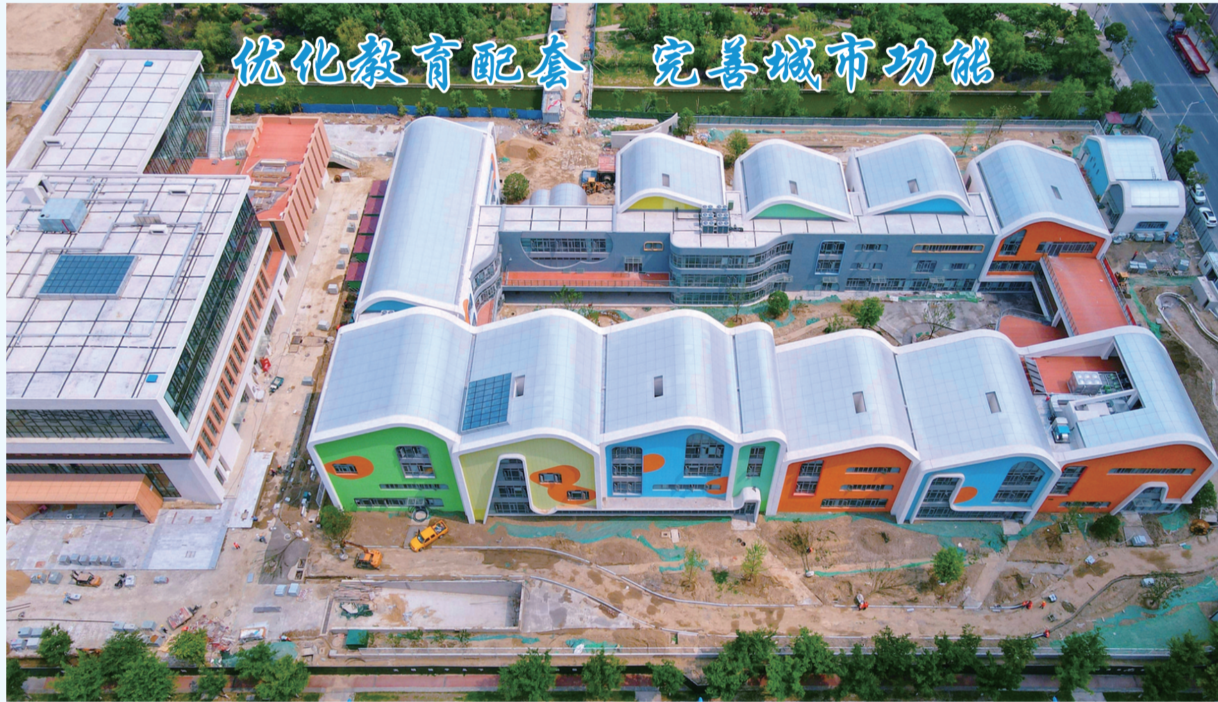
近年来，我市坚持把优先发展教育作为最大的民生工程，在新城区建设中大力提升区域教育配套水平，满足居民对优质教育资源的需求，切实改善民生福祉。图为主体工程已完工的如皋师范学校附属小学新城幼儿园项目。目前，该项目正在进行室内外配套施工，预计9月份可投入使用。 □通讯员吴树建
