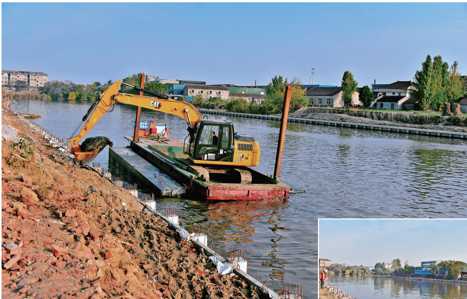
近日，在通扬运河（如皋段）整治工程建设现场，工人正抢抓当前冬季水利建设黄金时机，加快推进景观廊道建设。
