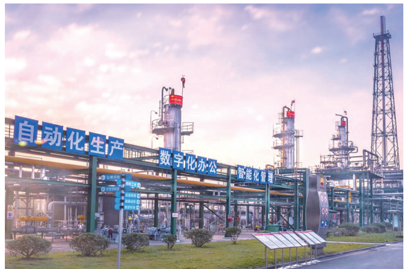
西南油气田天然气净化总厂大竹智能净化厂一隅（图片由西南油气田公司提供）
