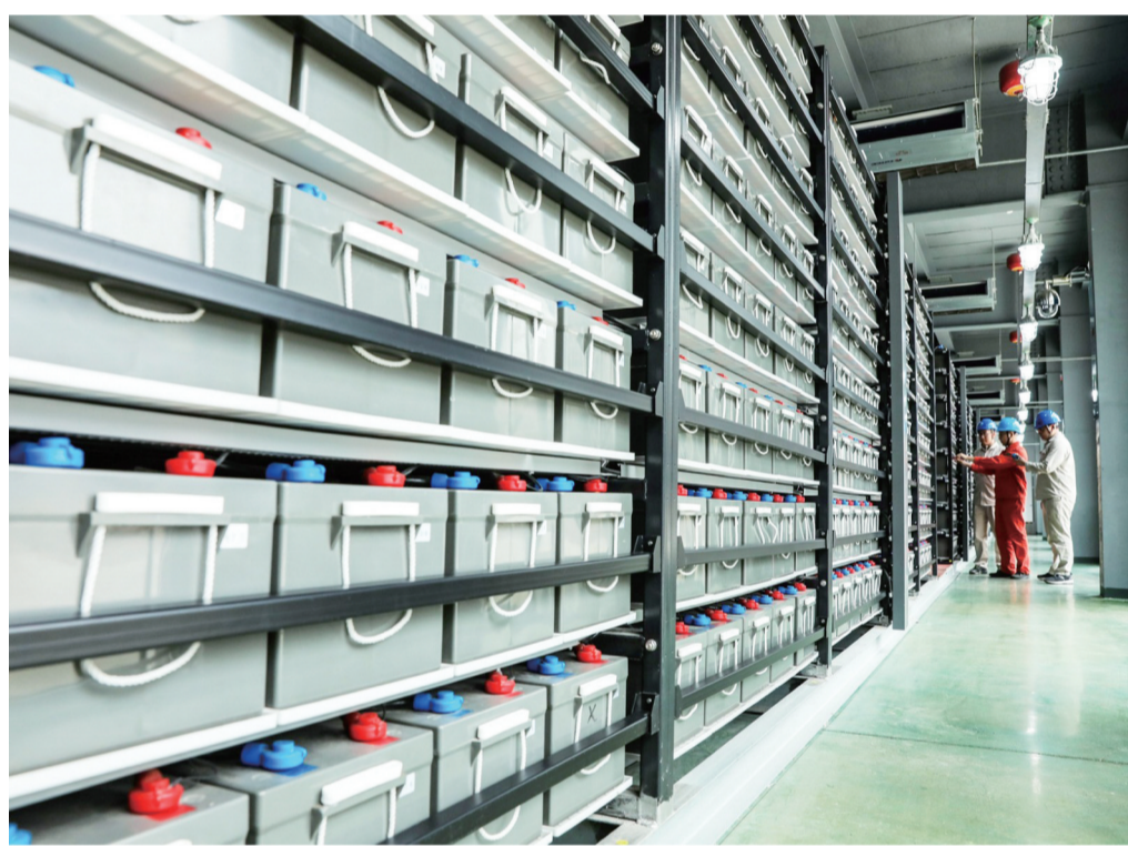
长兴县全国首座电网侧铅碳式储能电站。
