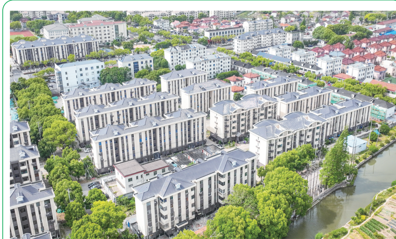
昨日,佘山镇天山新村改造现场正在进行外立面施工作业。近年来,松江区大力实施老旧小区改造工程,通过外墙维修、绿化亮化、管网改造等措施,完善小区配套功能,提升居民生活品质。 记者 蔡斌 摄
