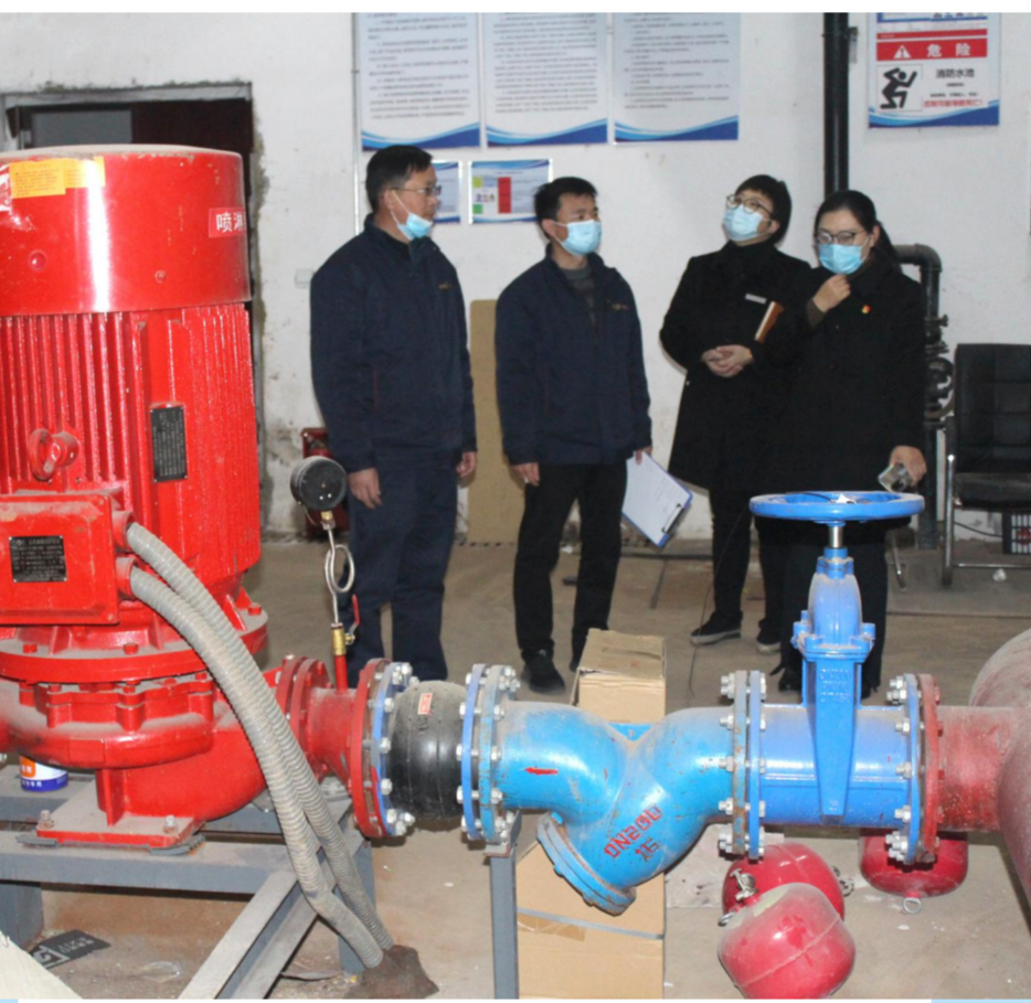
连日来,县行政审批局组织办公室、物业管理、保安联防等部门,对市民中心办公大楼的消防设施、电气设备、各类管道、监控设施、安全通道等涉及大楼安全的设施场所进行逐一检查,对发现的设施不配套、管理不到位等问题及时落实完善整改,保障市民中心运行安全有序。
