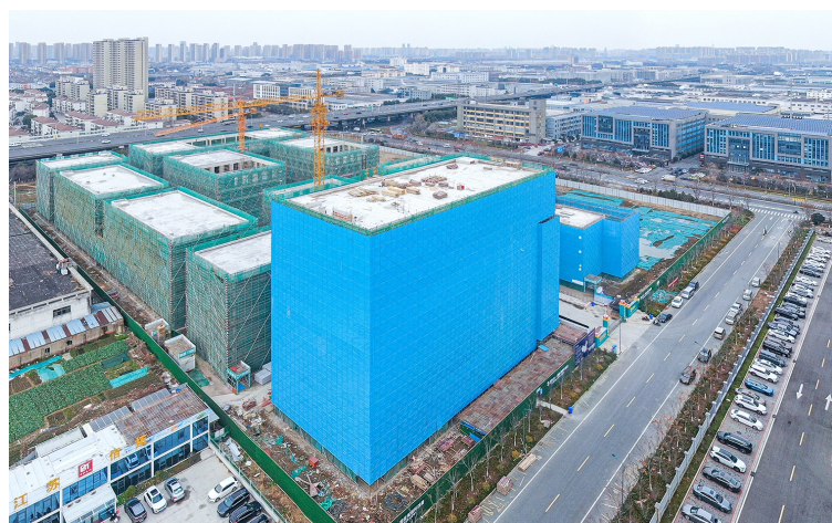
当前,区重点项目联东U谷·国经湖塘科创港项目已全面封顶,预计年底交付使用。该项目是全市首个混合所有制工业地产项目,总建筑面积约8.8万平方米,将重点聚焦高端装备制造、医疗器械、新能源等领域,建成集高标准厂房、研发中试楼、总部办公楼、服务配套于一体的现代化产业基地。图为项目建设现场。徐晶玮 摄
