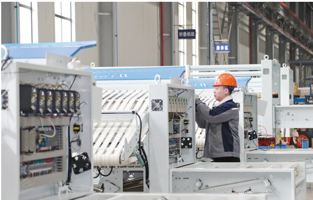
位于武进国家高新区的江苏威士智能装备有限公司,是一家从事生产自动化制衣设备、纺织品智能化洗涤设备及自动化物流输送系统的高新技术企业。去年,公司产值达6亿元,同比增长40%。图为节后复工后,员工在安装设备。 陆新 徐芊卉摄
