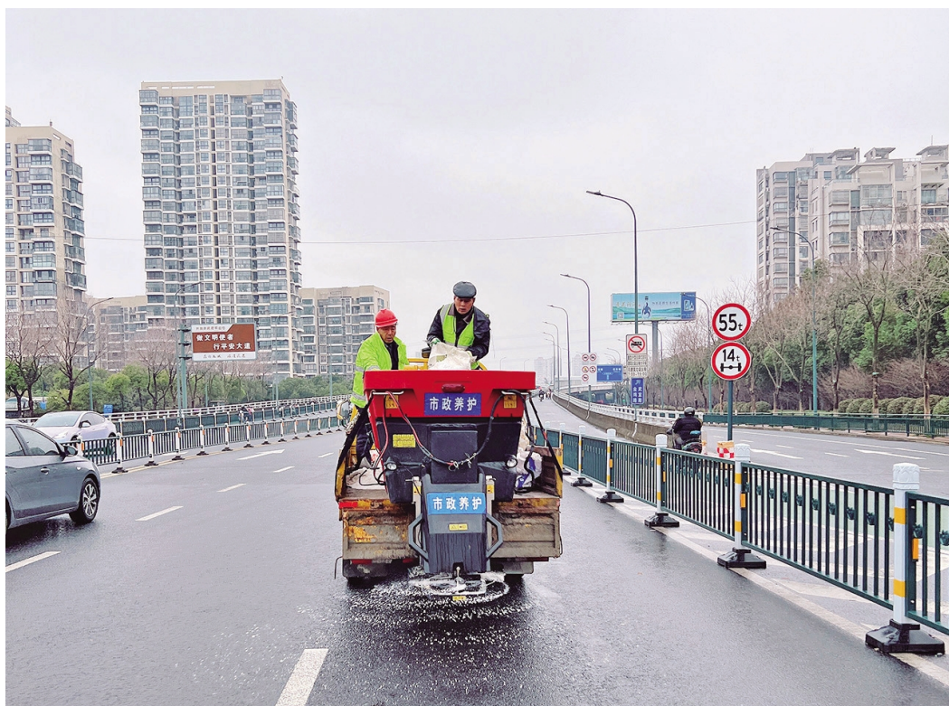
为保障市民安全出行,武进区市政公用事业管理处在雨雪冰冻天气来临前对部分路段进行撒盐除冰工作,减少交通事故发生,保障辖区道路交通秩序平稳顺畅。图为昨天,市政工作人员在聚湖路地铁站附近路段撒盐。 李军 何新雨摄
