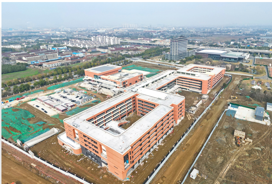
眼下,我区重点民生实事项目——南田培训中心正在进行幕墙及精装修施工,预计今年秋季学期投用。该项目总建筑面积约6.6万平方米,将建设12轨36班的初中、6轨36班的小学,扩大区域教育的辐射范围,进一步优化我区教育布局。徐晶玮 摄
