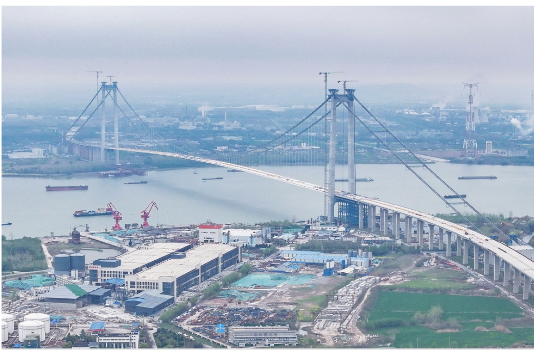
4月3日,随着最后一节钢箱梁就位,龙潭长江大桥主桥顺利合龙,各项配套施工稳步推进。据介绍,龙潭长江大桥北接扬州仪征市,南接南京市、镇江句容市,双向六车道,设计时速100公里,全长约5公里,预计将在2024年年底建成。图为3日拍摄的龙潭长江大桥。 新华社发
