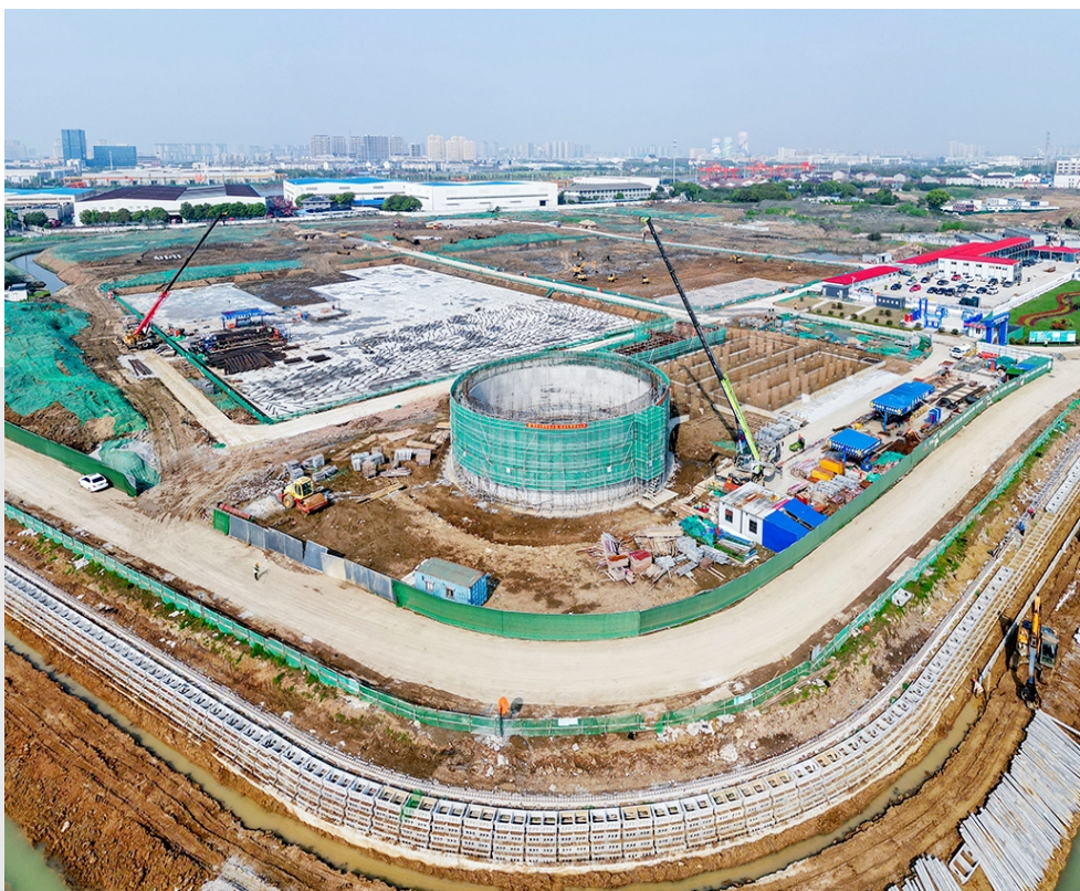
位于湖塘镇东升社区的阳湖生态净水厂是区重点民生实事项目,总投资约9.98亿元,生活污水处理能力将达20万吨/日,服务范围主要包括湖塘镇、武进国家高新区北区,服务人口约50万人。目前该项目正在加快建设,预计年内完成总工程量的50%。图为项目航拍。徐晶玮 摄
