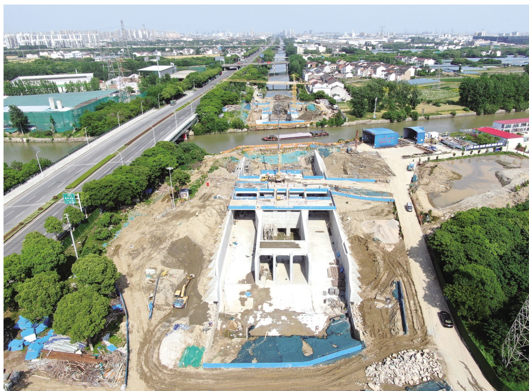
市“532”发展战略水利重点工程——武南河立交枢纽总投资13318.04万元，闸泵涵立交共体布置，分别建于武宜运河两侧武南河上，由东涵闸、立交地涵及西闸站三部分构成。目前该项目已基本完成水下施工和顶管施工，预计8月底水下验收，10月底试运行。图为项目航拍。 陆新 钱垒摄
