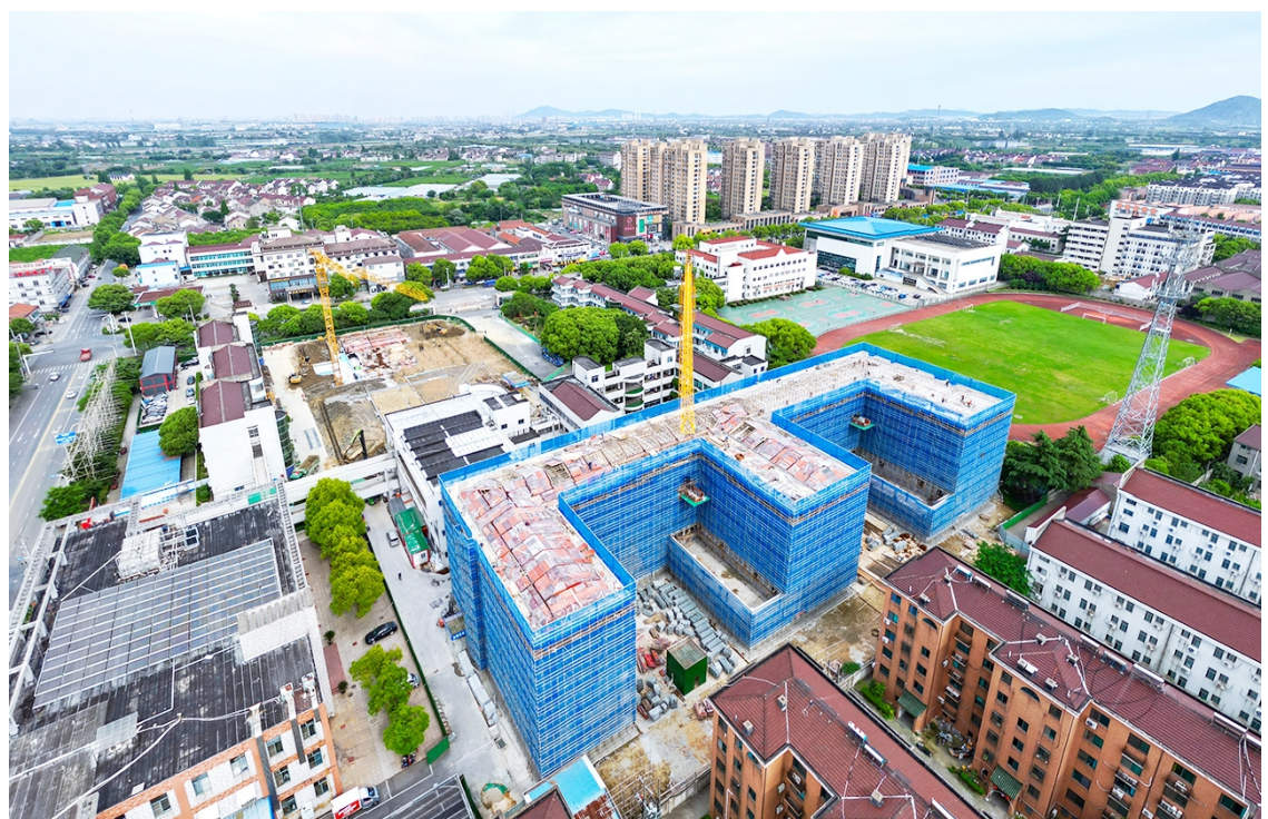
作为我区2024年重点民生实事项目的洛阳高级中学改扩建工程,目前宿舍楼已封顶。项目立足于该校办学特点及常武一体化招生实际,建成后的校舍总面积将增加约1.6万平方米,办学规模16轨共48班。
