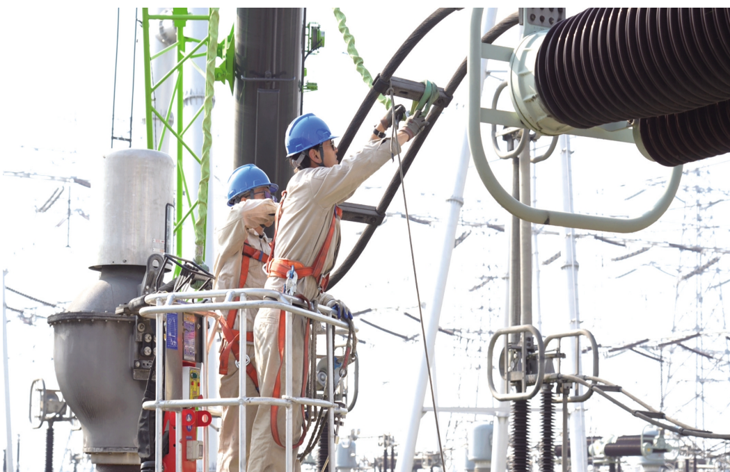
日前,位于我区的江苏常州500千伏武南变电站4号主变压器结束24小时试运行阶段,标志着江苏电网2024年首个500千伏迎峰度夏变电工程正式投运。本次工程扩建分3个阶段将站内3台主变压器由750兆伏安增容为1000兆伏安,增加的电量可为330万户家庭提供1年的用电。图为工作人员在调试设备。 傅琪雯 金琳 徐晶玮摄
