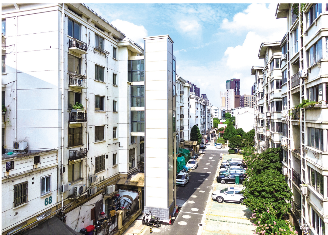
近年来，我区稳步推进老旧小区加装电梯民生实事项目。2024年计划完成既有住宅加装电梯10台，目前已有6台建设完成。图为已建成的湾里新村68幢甲单元的加装电梯。 陆新 徐晶玮摄
