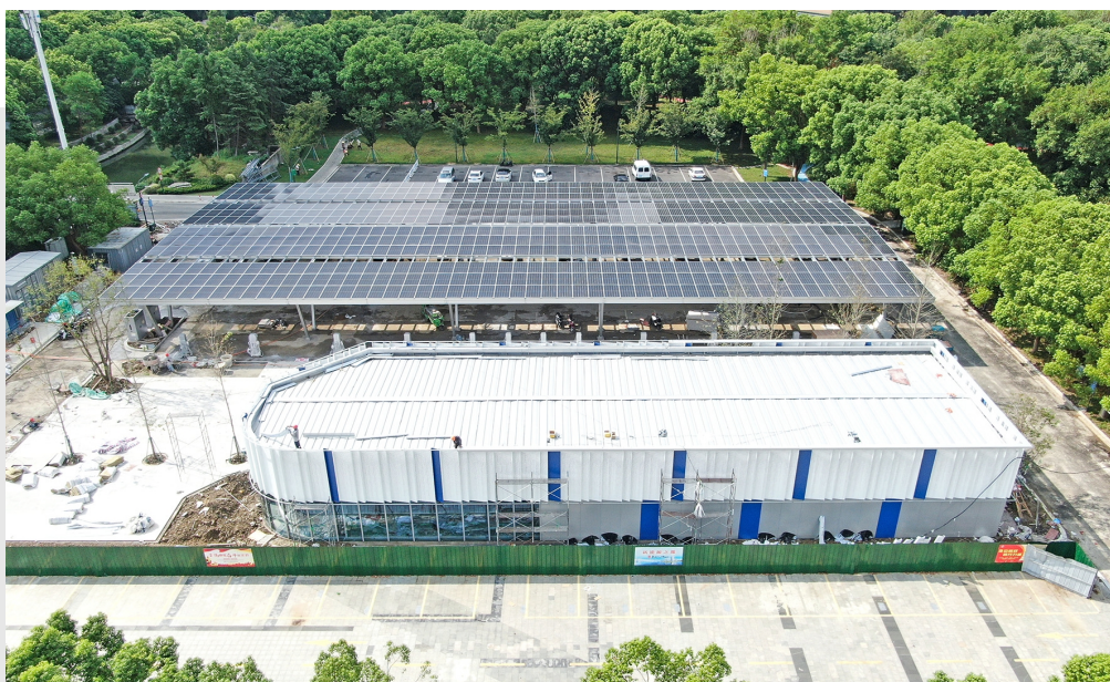
光充服务站项目位于凤凰谷西停车场内,拟打造集光伏发电、储能、新能源汽车充电等功能于一体的多功能综合充电站。项目新建15台160kW快充桩,2套600kW华为分体式充电桩(含4个超充,8个快充),5台120kW国网桩,可同时满足多种新能源车型的充电需求。目前建筑主体已完工,正在进行休息区建设,即将竣工投用。陆新 钱垒 摄
