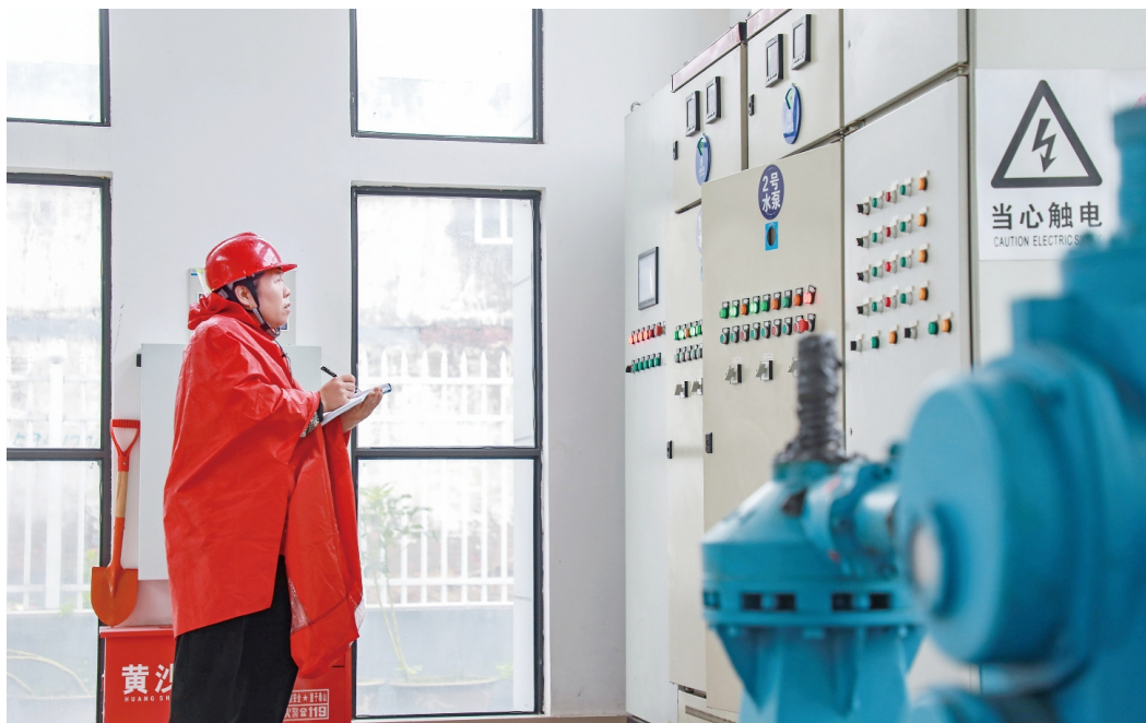
台风“康妮”带来暴风雨,区水利枢纽管理中心全力保障防台安全,对枢纽重点运行部位进行全方位巡查,确保城区内河水位维持在安全水位,各类水泵机组能够正常运行。图为昨日在龚巷河北枢纽,工作人员对泵房进行巡检。 陆新 徐晶玮摄
