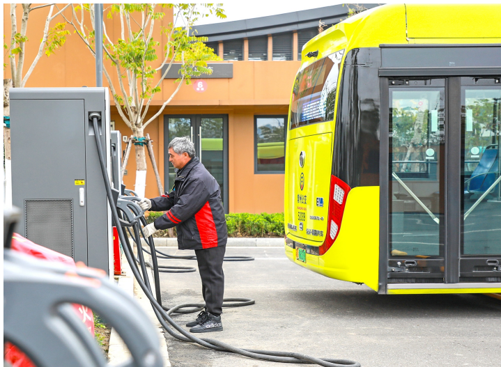
武进区南沿江公交车站充电站项目是武进经发集团与常州公交集团合作建设的首个公共交通枢纽充电站项目，目前已正式投入使用。该项目安装直流“帮武充”充电桩，每台充电桩配备180kW双充电桩，能够高效满足公交车快速充电的需求，为公交系统的高效运行提供了有力支持。图为工作人员正在充电站内为公交车充电。
