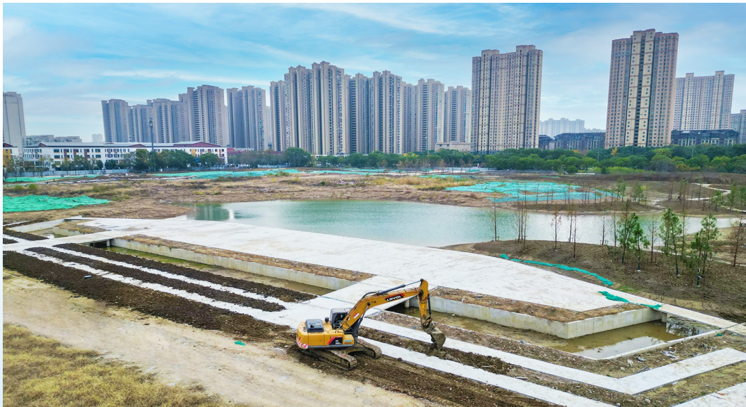
位于火炬路的武进国家高新区北区公园是一个在建的大型城市公园项目，占地12.5万平方米，目前正在进行配套景观绿化工程，建成后将成为集休闲、娱乐、运动等功能于一体的城市绿肺，为周边居民提供生态宜居的人居环境。陆新 徐芊卉 摄
