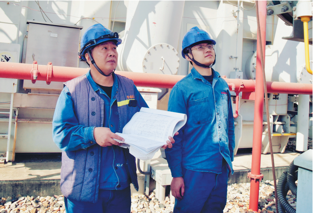
华美热电公司以党的二十大精神为指导,严守底线保安全,主动担当稳保供,以饱满热情战年终,确保全年各项目标任务圆满顺利完成。图为电气专业人员在检查220KV电路运行情况。
