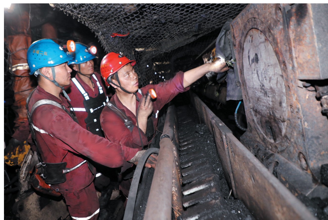
中煤大屯煤电公司徐矿持续加大机电设备检查力度,不断强化设备管理,从隐患排查、设备检修、正规操作等方面入手,全力做好机电设备维护保养,为矿井安全高效生产提供有力支撑。图为该矿检修人员对井下设备进行巡检。
